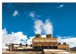
西藏羊八井地热发电站
