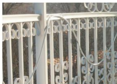
图 18 安装了电磁感应式震动电缆的围墙
